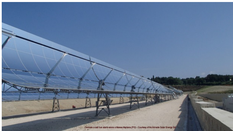
Figura 40 - Impianto dimostrativo in funzionamento
