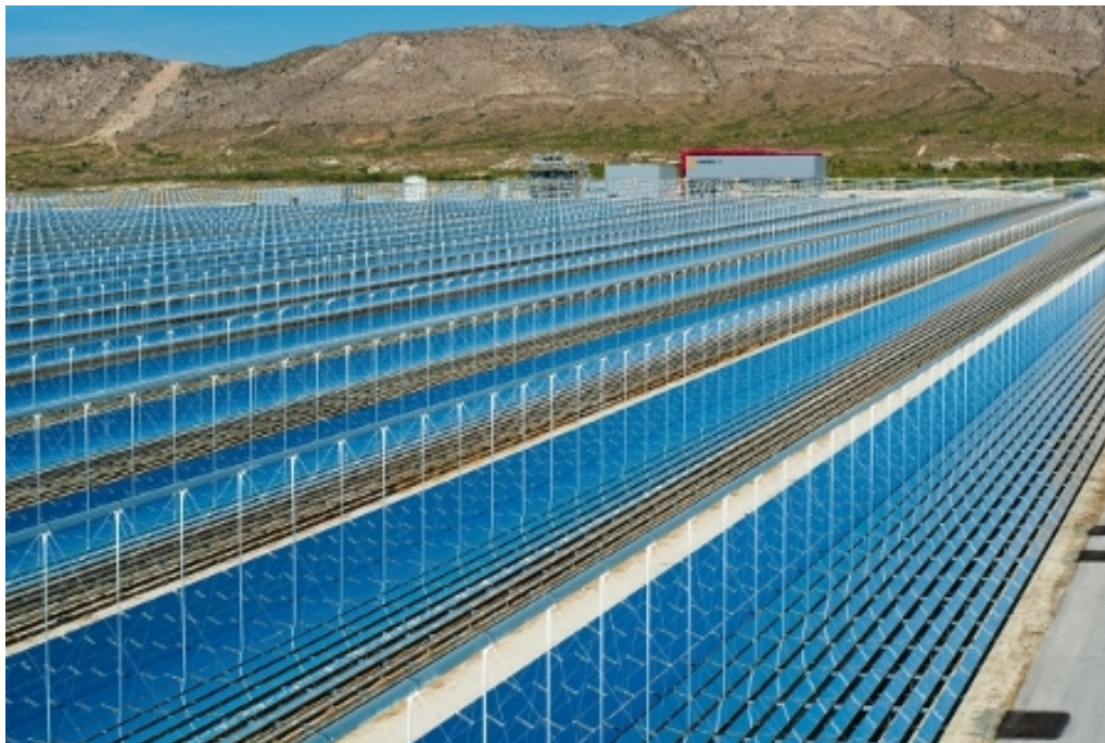
Figura 6 - Impianto solare di Puerto Errado 2, Spagna
