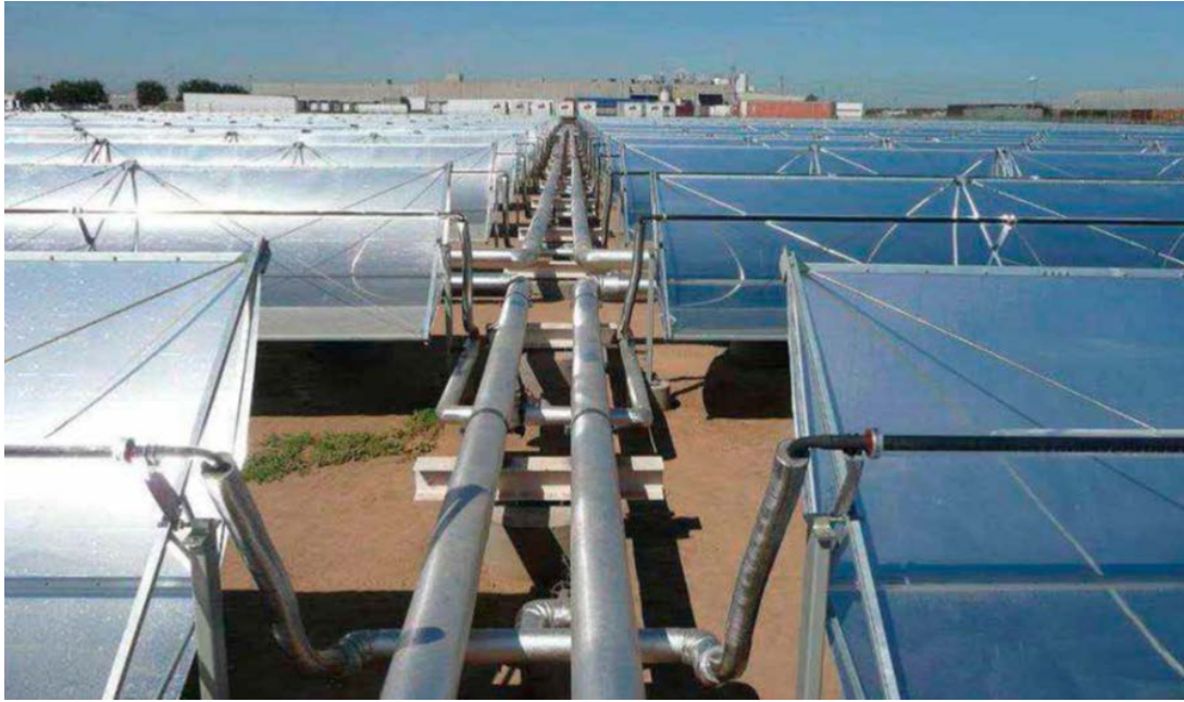
Figura 19 - Impianto di Modesto – Abengoa
