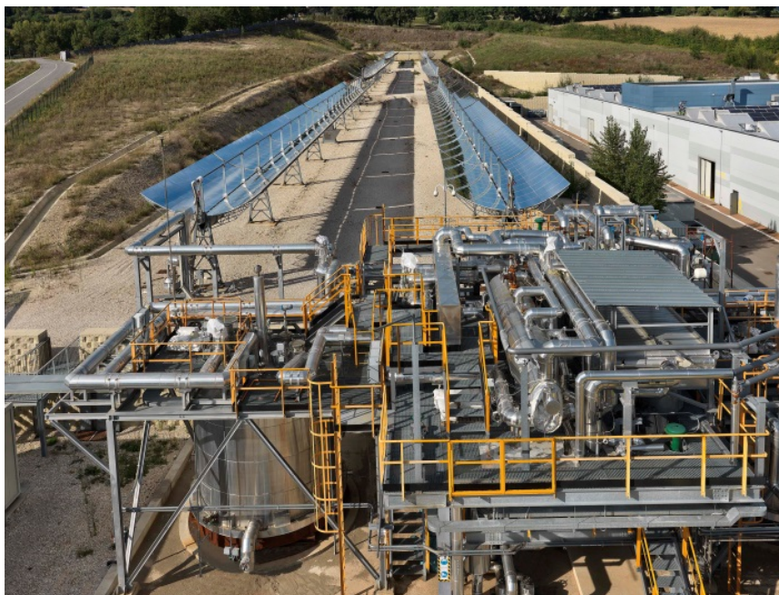
Figura 41 - Vista del sistema di generazione del vapore
